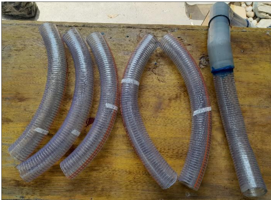
Fotografía 4: Componentes del sistema de drenaje (válvula de bola de diámetro de 2 pulgadas y tubo corrugado transparente cortado en la bajante principal)
