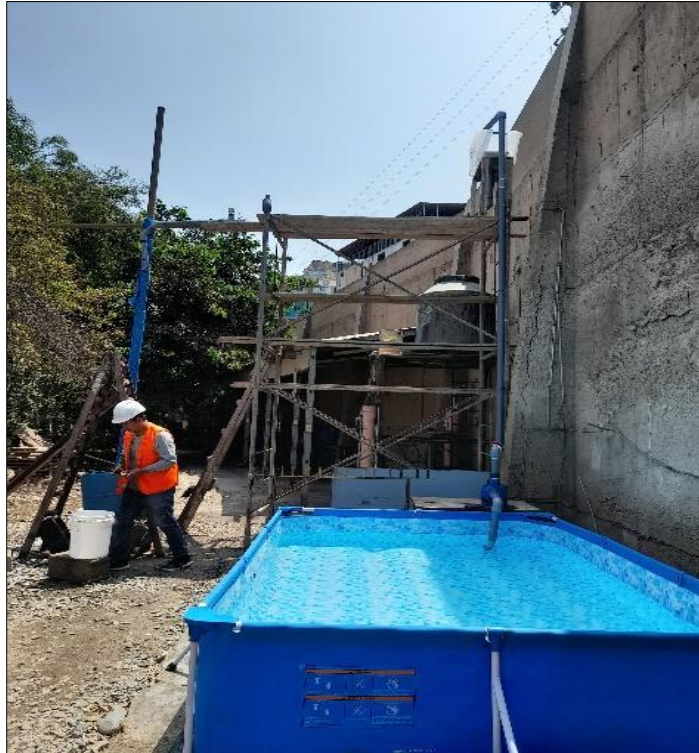
Fotografía 6: Corte de tubería para la configuración de instalaciones tipo 45 y 90 en la bajante principal
