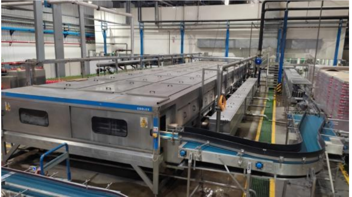
Túnel de enfriamiento – línea HF
