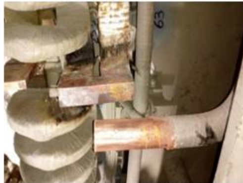
Vista de conexión nueva "V"
