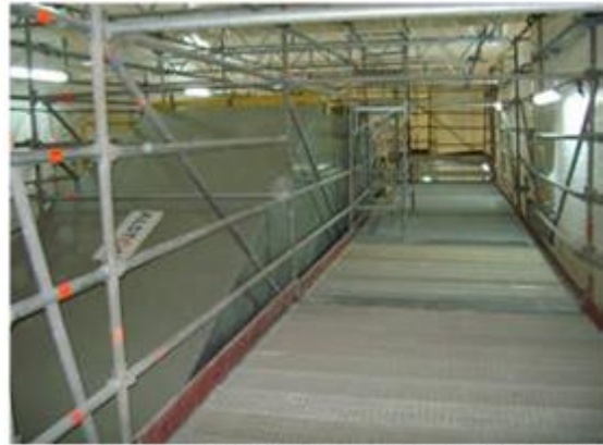
Vista de interior del encerramiento de lugar de trabajo
