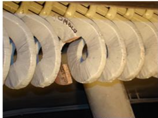
Corte de extremos de bobina en falla
