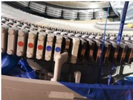
Vista de cabezas de bobinas
