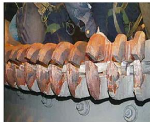
Cabezas de bobinas con uniones desoldadas
