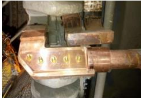
Vista de conexión nueva "Y"
