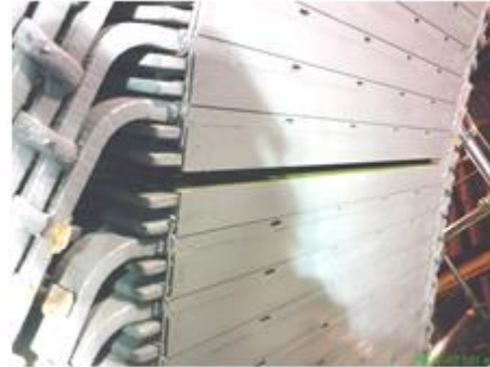
Extracción de barra superior en falla
