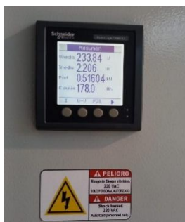
Medidor Digital de Potencia, Corriente y Voltaje
