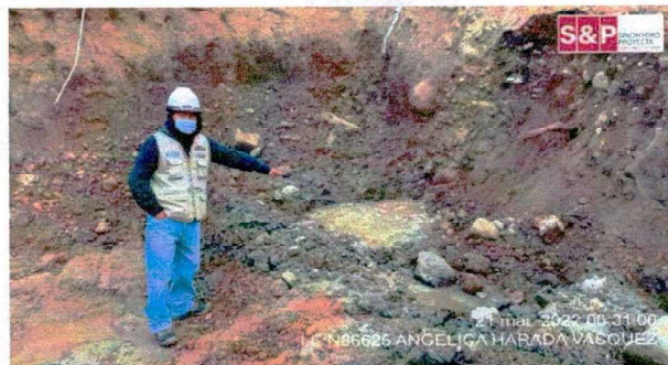
lunes 21-03-22, se ha identificado que persiste la filtracion.
