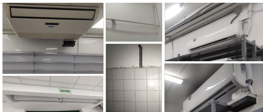
Figura 142. INK 571 CHICLAYO – Instalaciones de Aire Acondicionado
