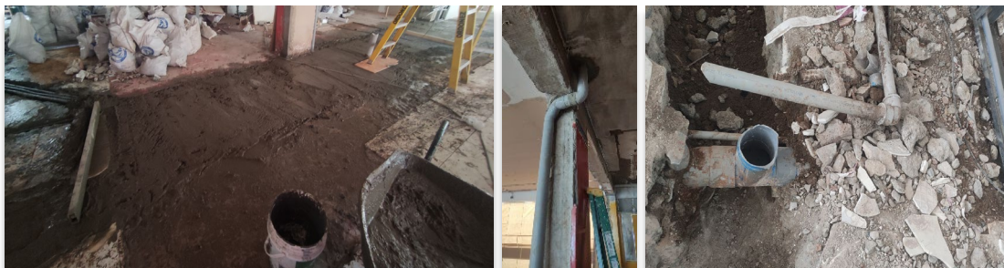
Figura 107. SP40 CHACARILLA – Instalaciones sanitarias
