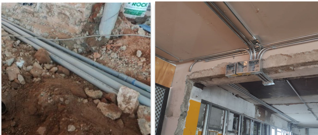
Figura 108. SP40 CHACARILLA – Instalaciones eléctricas
