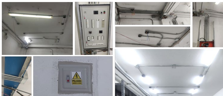
Figura 141. INK 571 CHICLAYO – Instalaciones eléctricas
