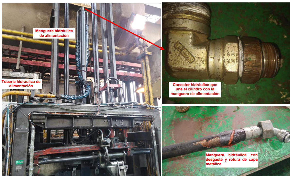
Tubería y manguera hidráulica de alimentación
