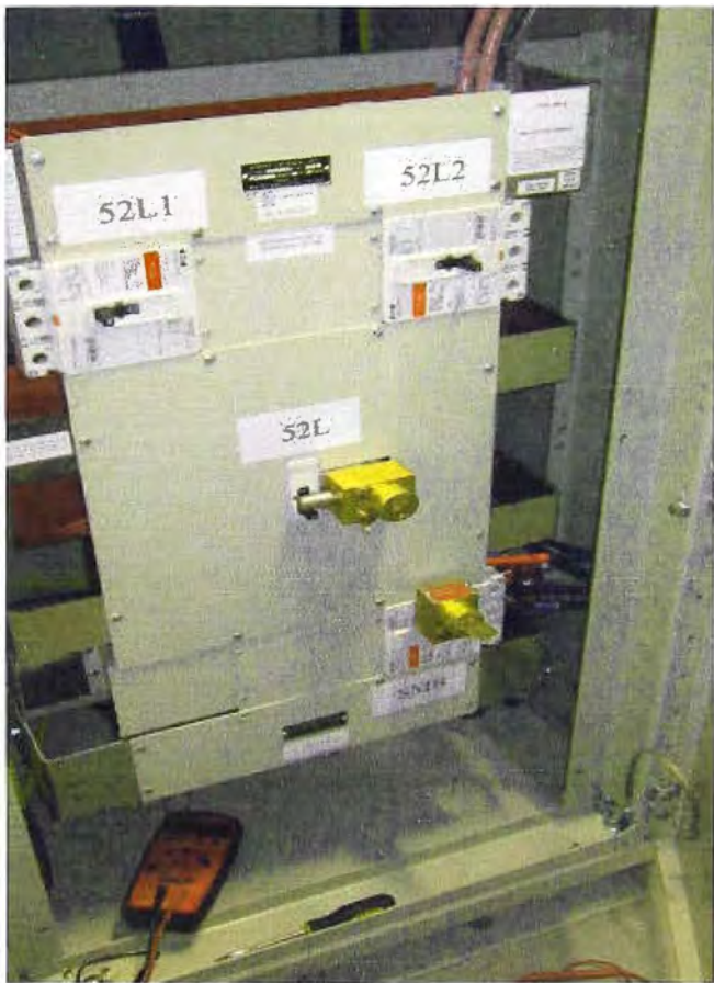
Figura 5.16: Montaje de CLC (Tablero para redundancia) en Centro de Cómputo.
