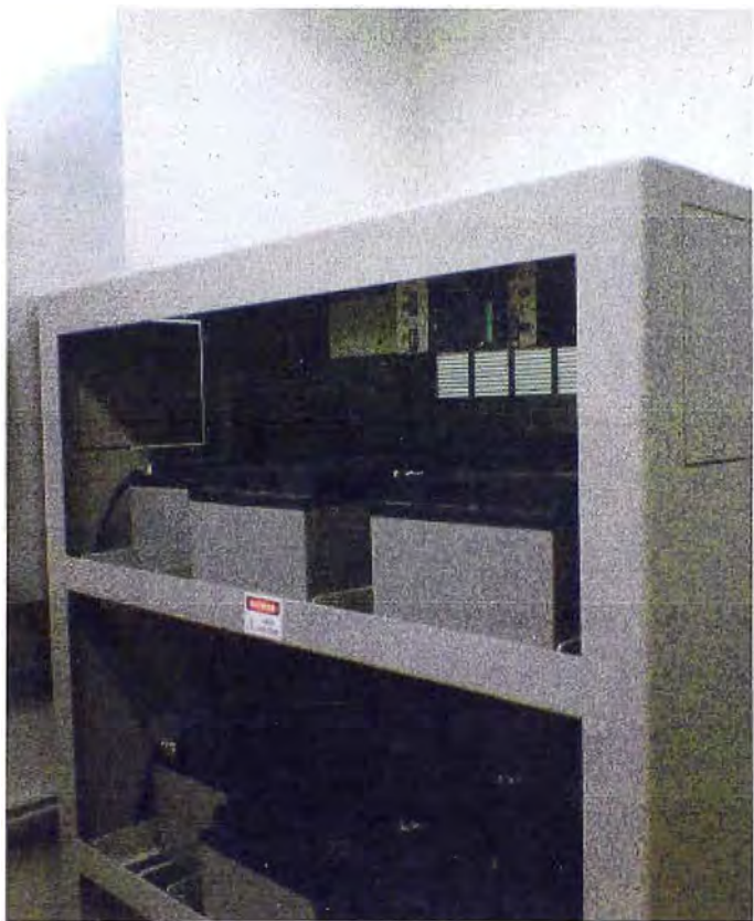
Figura 5.13: Montaje de Banco de Baterías de UPS Mitsubishi.
