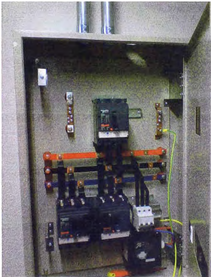
Figura 5.14: Montaje de Tableros General del Centro de Cómputo (TD-9).
