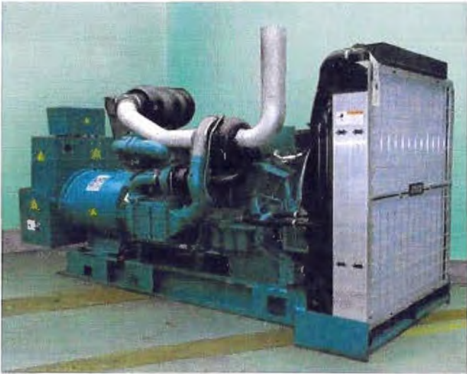
Figura 5.11: Grupo Electrógeno, modelo RVM-117 (aún sin instalar).
